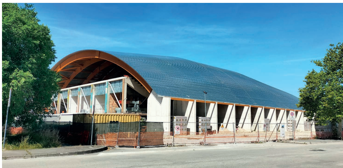
Il PalaGuerrieri, dove languono i lavori di ristrutturazione iniziati due anni e mezzo fa
